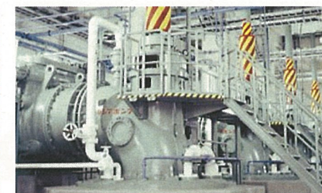
下水道用ポンプ
