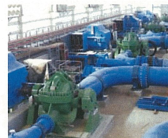
上水道用ポンプ
